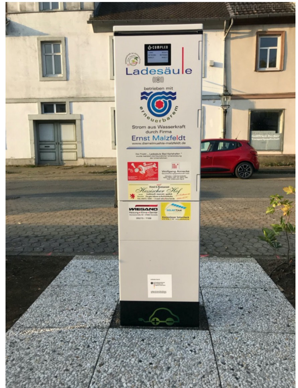
Abb.: Ladestation Bad Karlshafen
