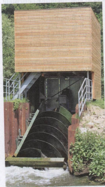
Mit einer Wasserkraftschnecke kann eine energetische Nutzung des Restwassers erfolgen und die Restwassermenge kontrolliert werden.
